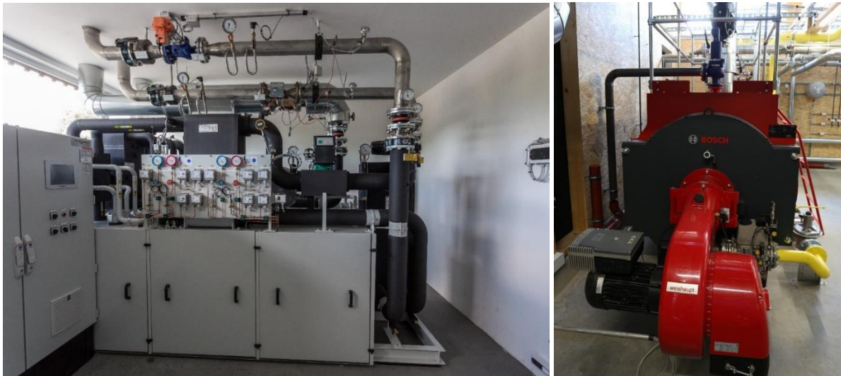
Abbildung 5: Wärmepumpe (links) und Spitzenlastkessel (rechts) Wärmepumpenzentrale
