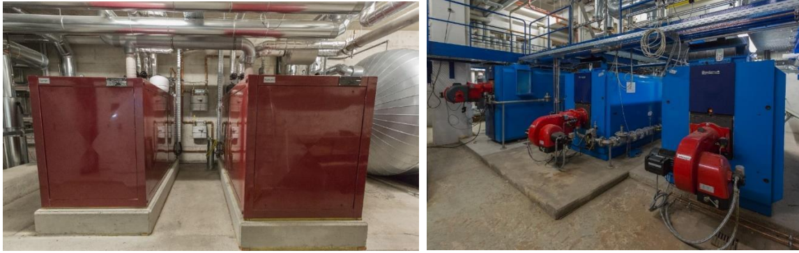
Abbildung 4: BHKW (links) und Spitzenlastkessel (rechts) Heizzentrale Schule
